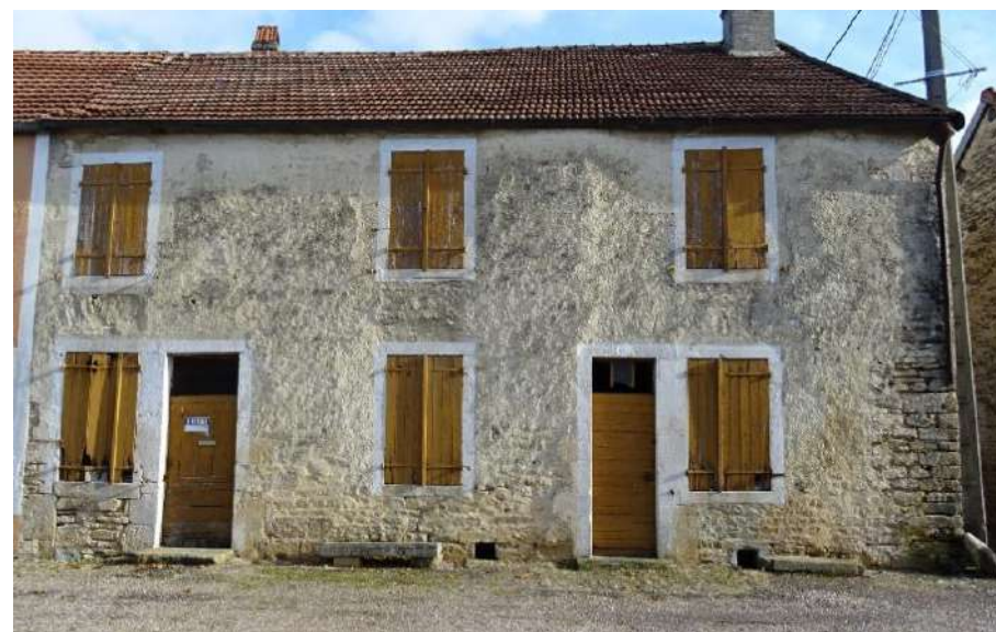
Mur en maçonnerie recouvert d'un enduit à la chaux à pierre vue – 25, rue Carnot
